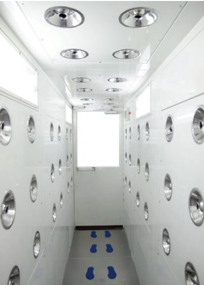
作業用エアシャワー
